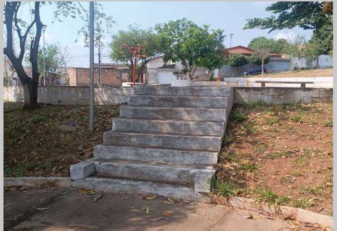
Fig. 5: Praça Sebastião Ananias Silva, destaque para ausência de guarda corpo
