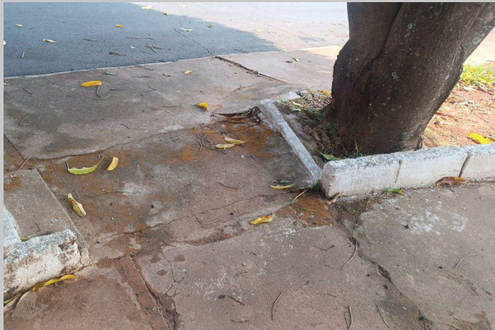
Fig. 6: Praça Sebastião Ananias Silva, destaque calçada danificada
